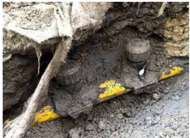
...nachdem aus der beschädigten Gasleitung Gas austrat.
