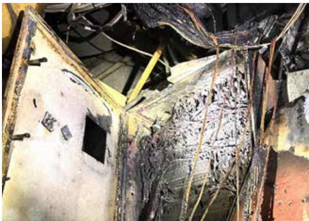
Der Supermarkt wurde schwer beschädigt.
