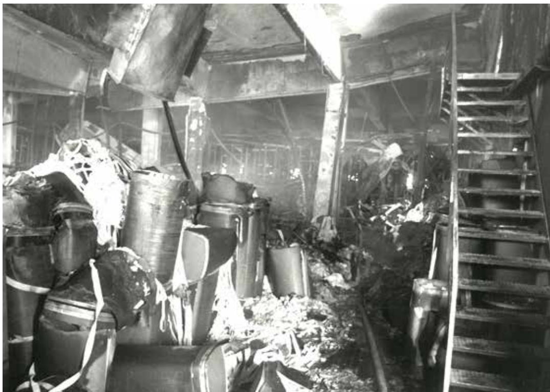
Die Zerstörung war enorm. Das Betriebsgebäude war einsturzgefährdet.
