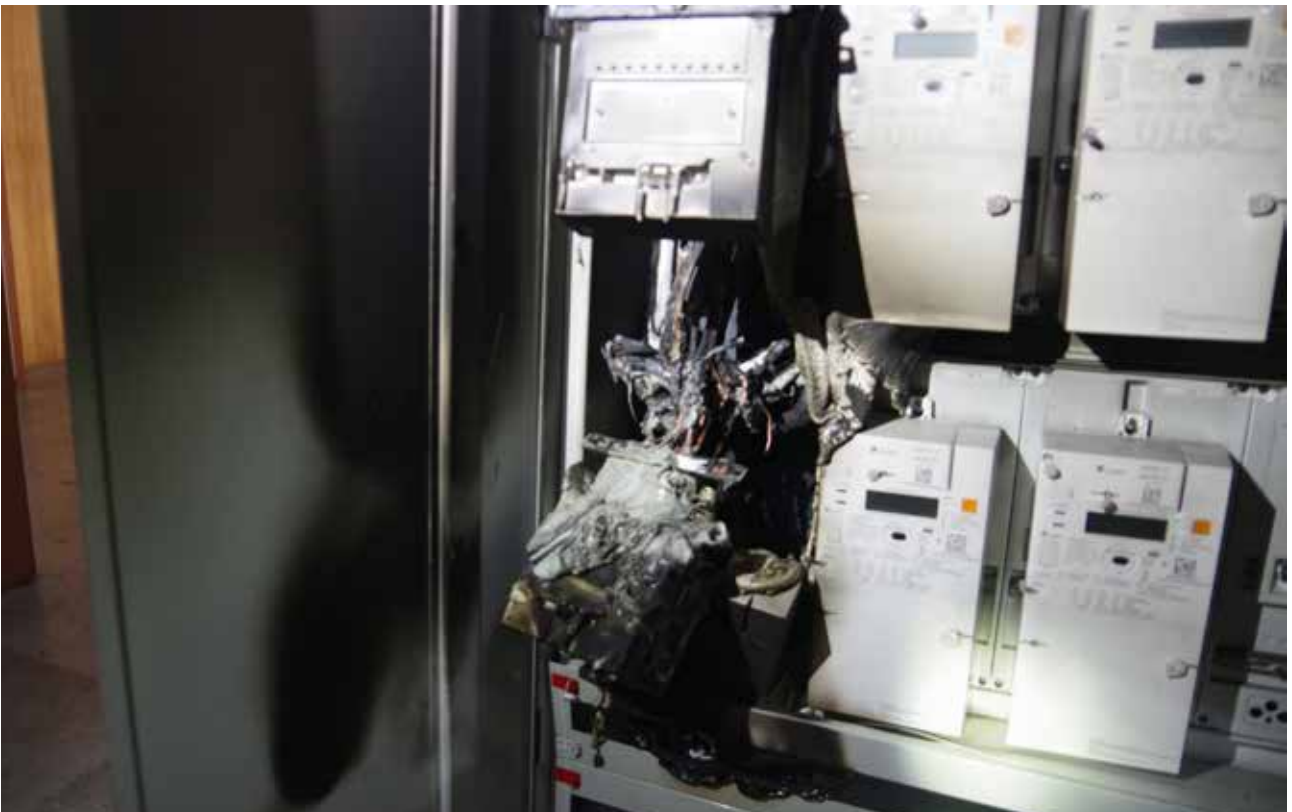
Der Verteilerkasten wurde arg in Mitleidenschaft gezogen.
