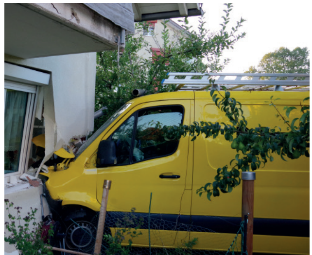
...und steckte in der Hauswand.
