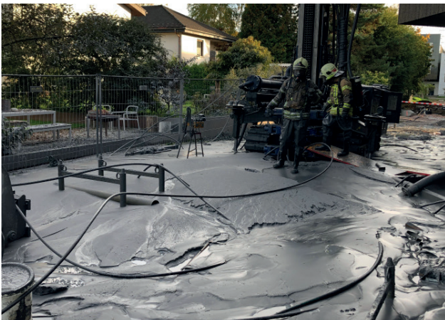
Mit dem Gas wurde auch viel Schlamm an die Oberfläche befördert.
