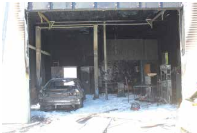
Die Werkstätte ist komplett ausgebrannt.
