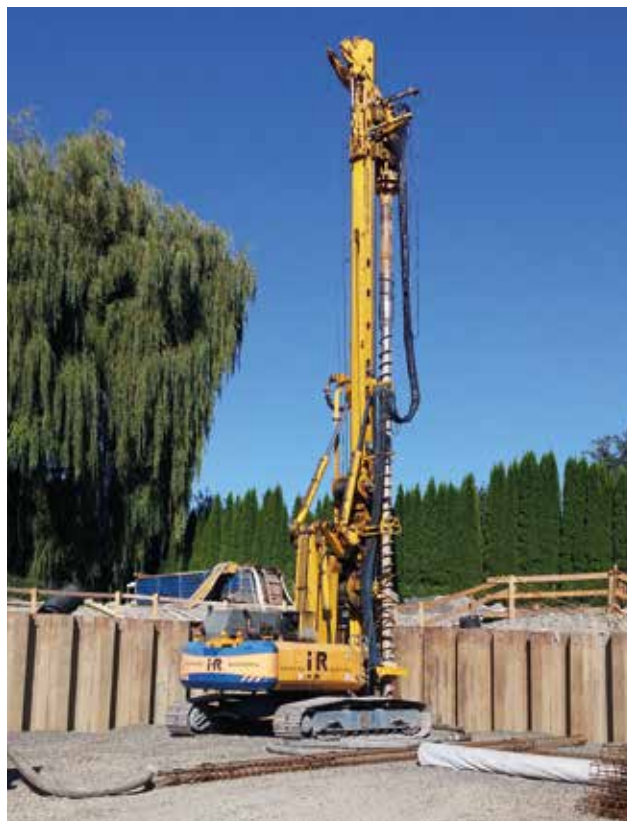
Von der Baustelle wurden insgesamt 8000 m 3 Aushub abtransportiert, bevor erfolgter Grundwasserabsenkung der Spezialtiefbau rund 4200m Bohrpfähle im Boden versenken konnte.
