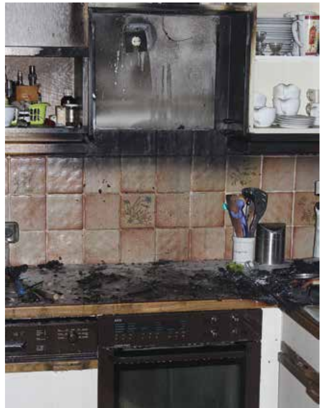
Der Küchenblock inkl. Dunstabzug wurde stark beschädigt
